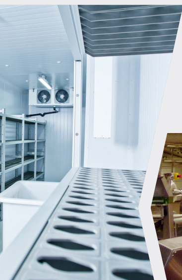
Celle frigorifere (0 °C / +8 °C) Celle di abbattimento
